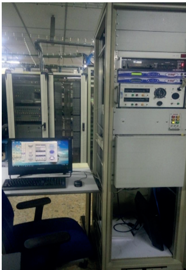
Figura 7. Estación Remota, Sala Técnica, Rionegro.
