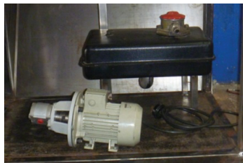
Fig. 68. Sistema de lubricación (Tanque, filtro de retorno, motor AC con arrancador, campana de acople y bomba de engranaje) en la bancada de la TGBP.
