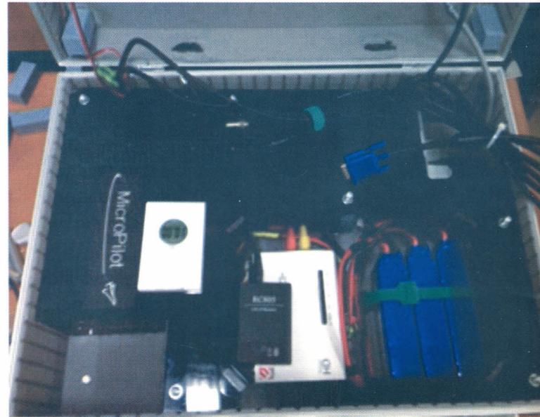
Figura 12. Distribución de los componentes al interior de la estación de control.
